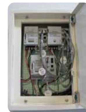
電力監視装置
