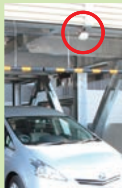
DSRC路側アンテナが設置された駐車場ゲート。
