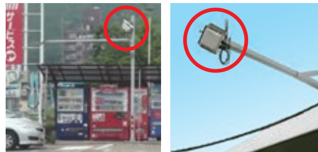
宇高国道フェリーの乗船場ではDSRC路側アンテナを4カ所に設置。複数の場所に設置されたDSRC路側アンテナで取得した情報も、1カ所に集約することができます。
